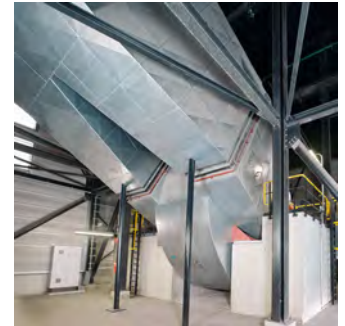
Photo: Salzgitter Flachstahl GmbH
